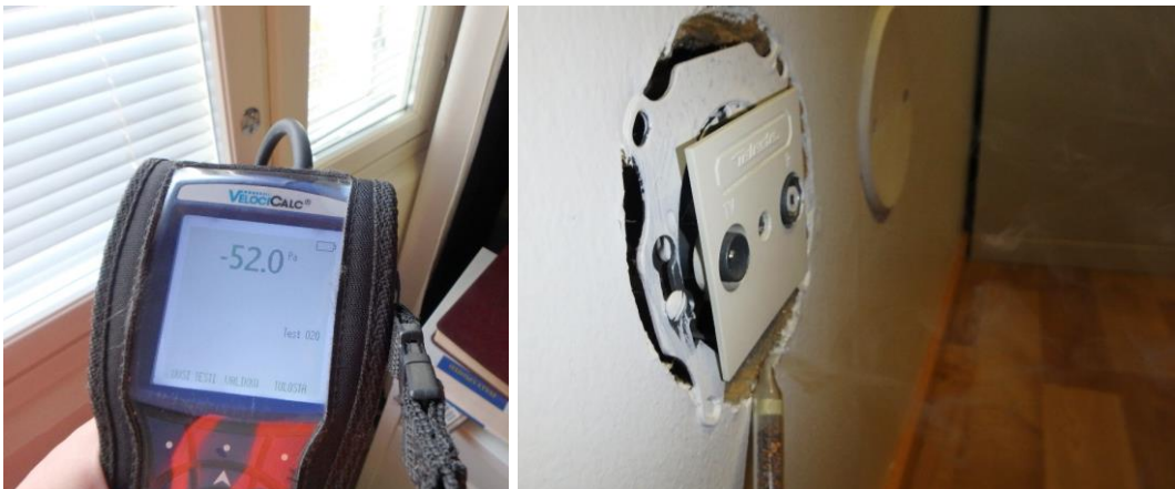
Kuva 2. Korvausilman puutteeseen tai liian suureen puhaltimien käyntiin viittaavia havaintoja.
