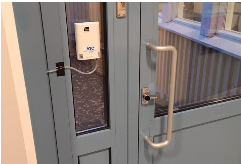
Kuva 57. Seurantajärjestelmän paine-erolähettimen mittaus johdettu ulos 4/2 mm pneumatiikkaletkulla [Antti Alanko]
