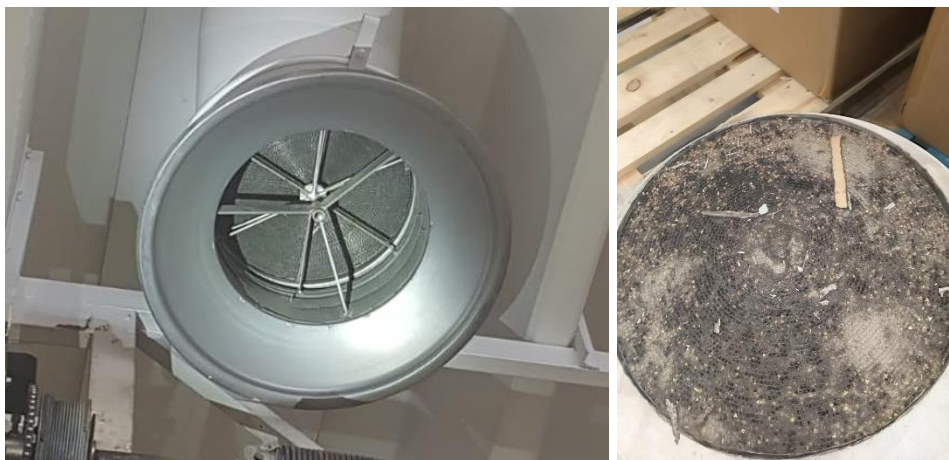
Kuva 68. Likaantunut laminaaritasaaaja tuloilmahajottajan takana [Hannes Hannula]
