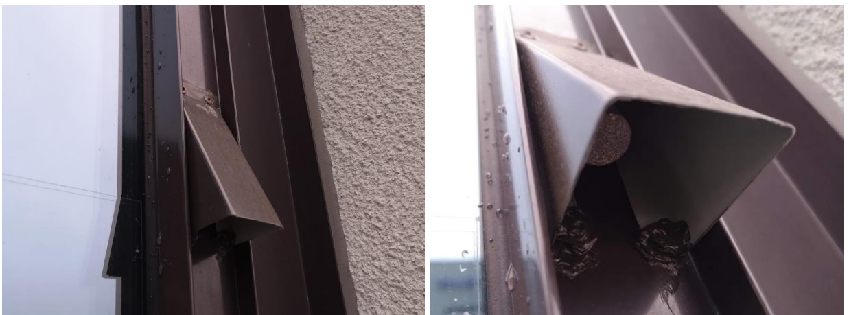
Kuva 58. Esimerkki kiinteän paine-eromittauksen sääsuojauksesta [Antti Alanko]
