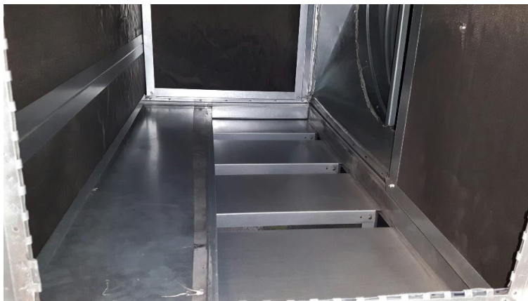
Kuva 17. Ilmanvaihtokoneen kulmaäänenvaimentimen liitos tehty liian ahtaaksi, eikä puhallin pystynyt tuottamaan mitoitettua ilmavirtausta.
