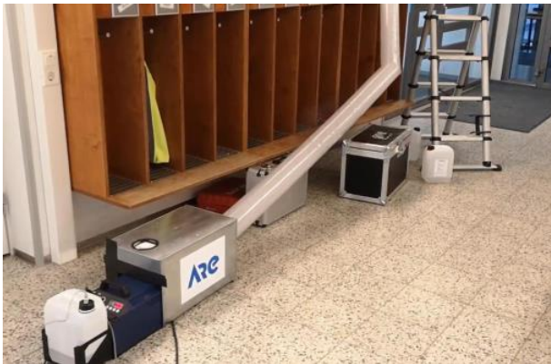
Kuva 9. Ilmanjaon savukoelaitteisto kanavistoon kytkettynä. [Antti Alanko]
