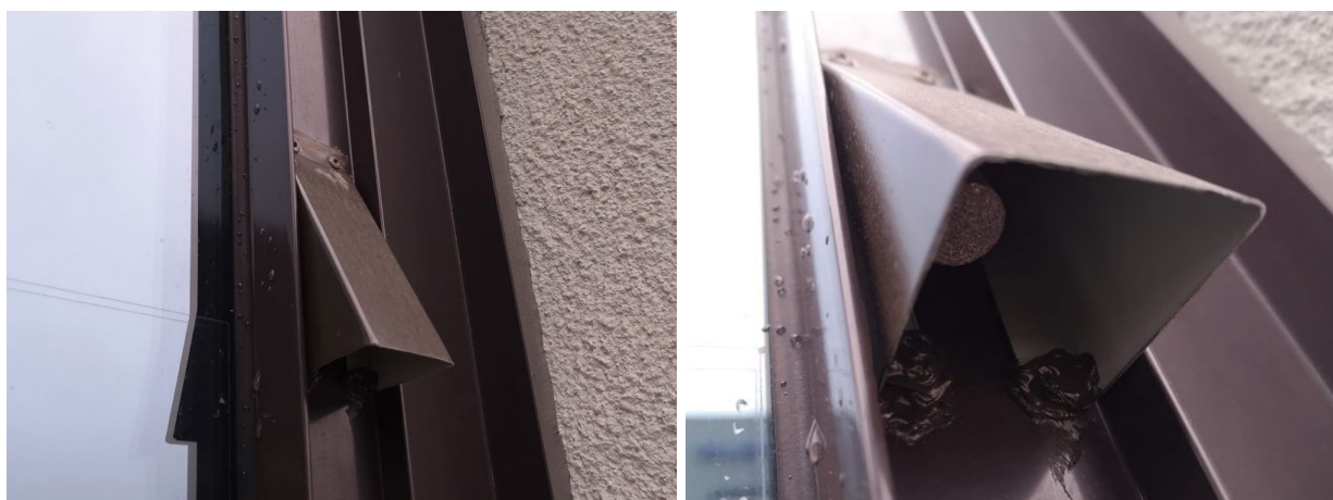
Kuva 58. Esimerkki kiinteän paine-eromittauksen sääsuojauksesta [Antti Alanko]
