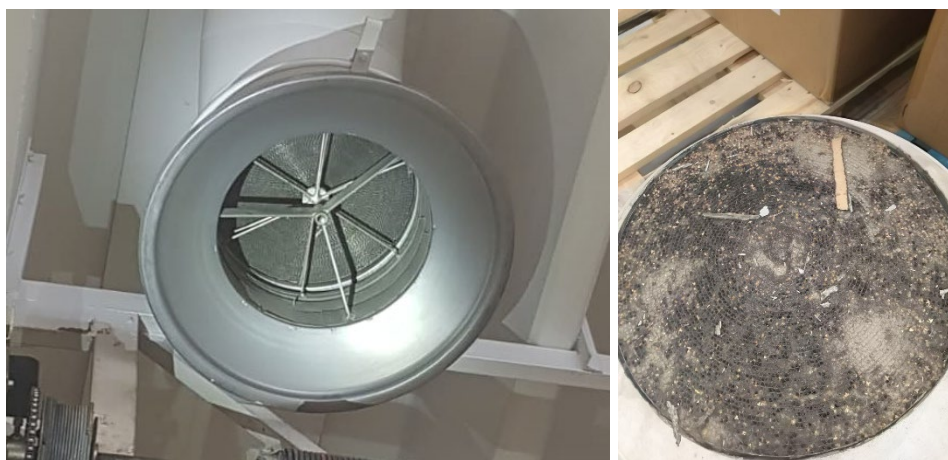
Kuva 68. Likaantunut laminaaritasaaaja tuloilmahajottajan takana [Hannes Hannula]
